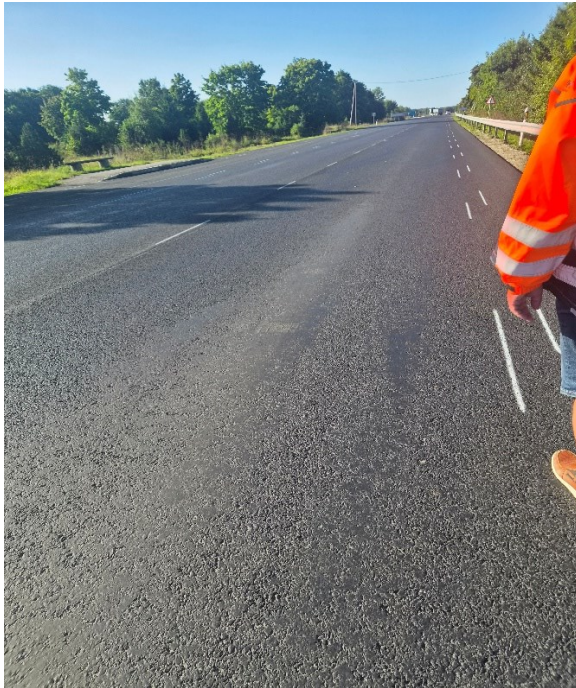
Pilt 1. Bituumeniga küllastunud kohad
